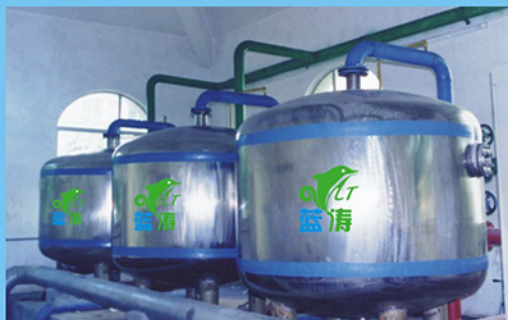
不锈钢过滤器机房
