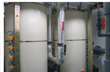
大型电加热机房
